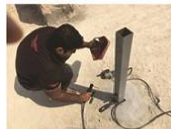
ساخت دیواره سنگ مالون و نصب پروفیل جهت تعیین حدود خودرو مسافران دره ستاره ها
