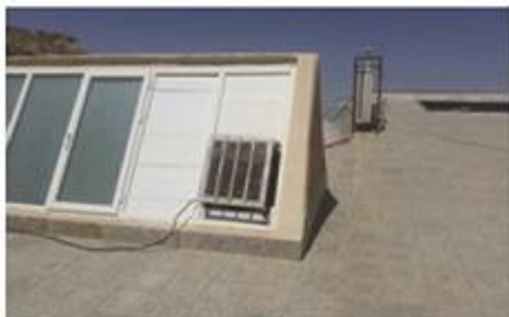
نصب فن صنعتی همراه با حفاظ جهت تهویه ساختمان پذیرمان دره ستاره ها
