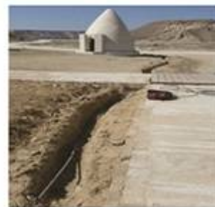
ساماندهی بیرون زدگی کابل برق محوطه جلوی ساختمان پذیرمان دره ستاره ها
